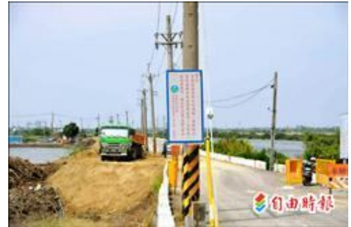
西濱公路濱海橋以西的污水廠進場道路工程施工，原有的潮溝已填平，紅樹林都不見了。（記者蔡文居攝）
